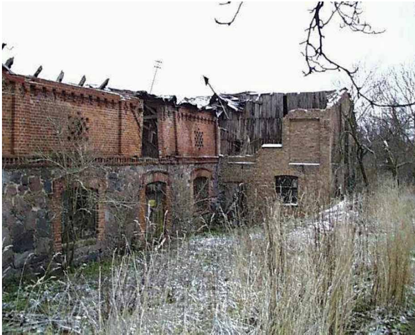
Ruinöses ehemaliges Gutsstallgebäude in Peckatel, 2000. Foto: Hermann Behrens.
